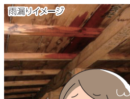
雨漏りイメージ
